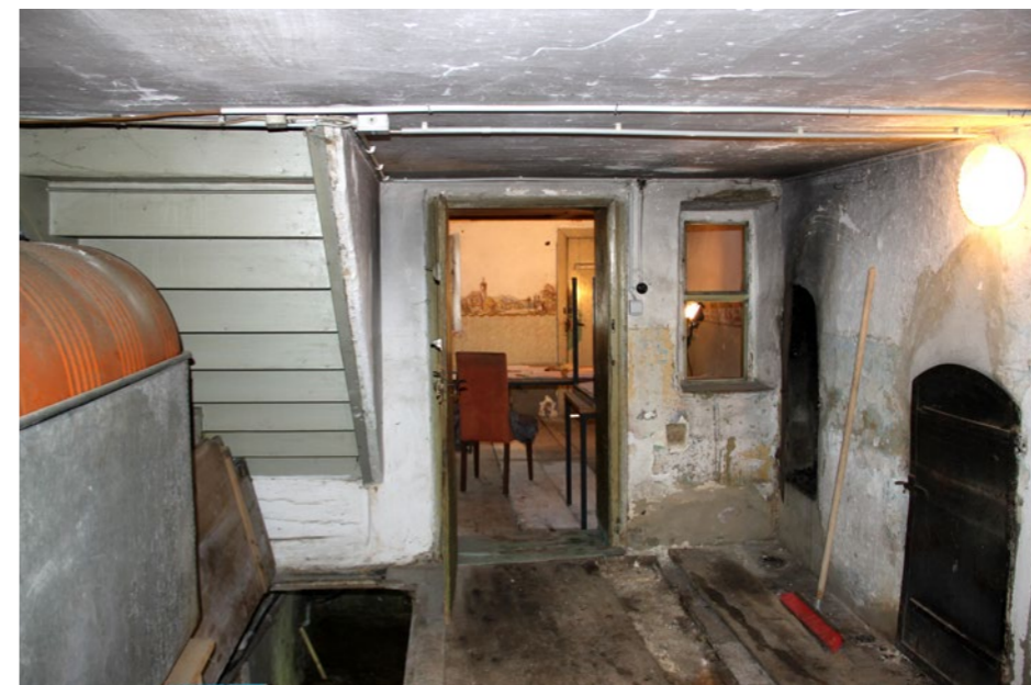
Der Zustand des Hauses vor Beginn der aufwändigen Sanierungsarbeiten.
